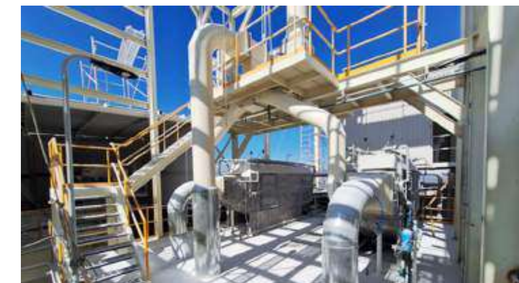
Recuperador de agua evaporada en el proceso de hidratación Planta Progreso
