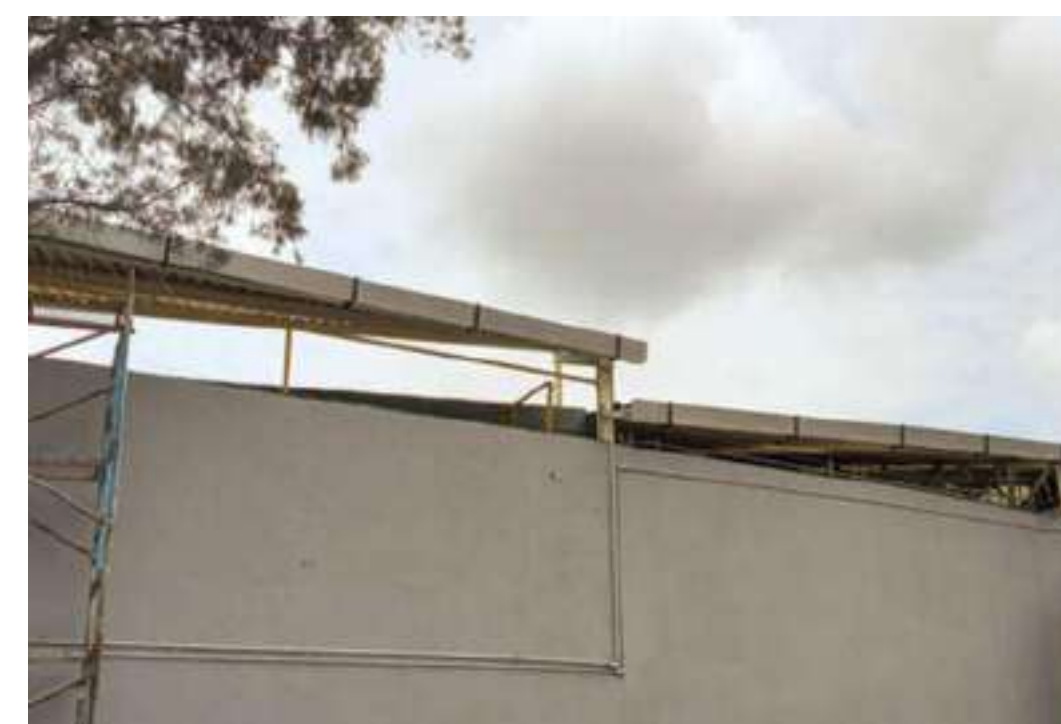
Canalones en techumbres para recuperar el agua pluvial en Planta Progreso
